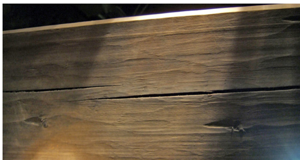
Bearbetningsspår på takstolsdelar i Hackås kyrka.
