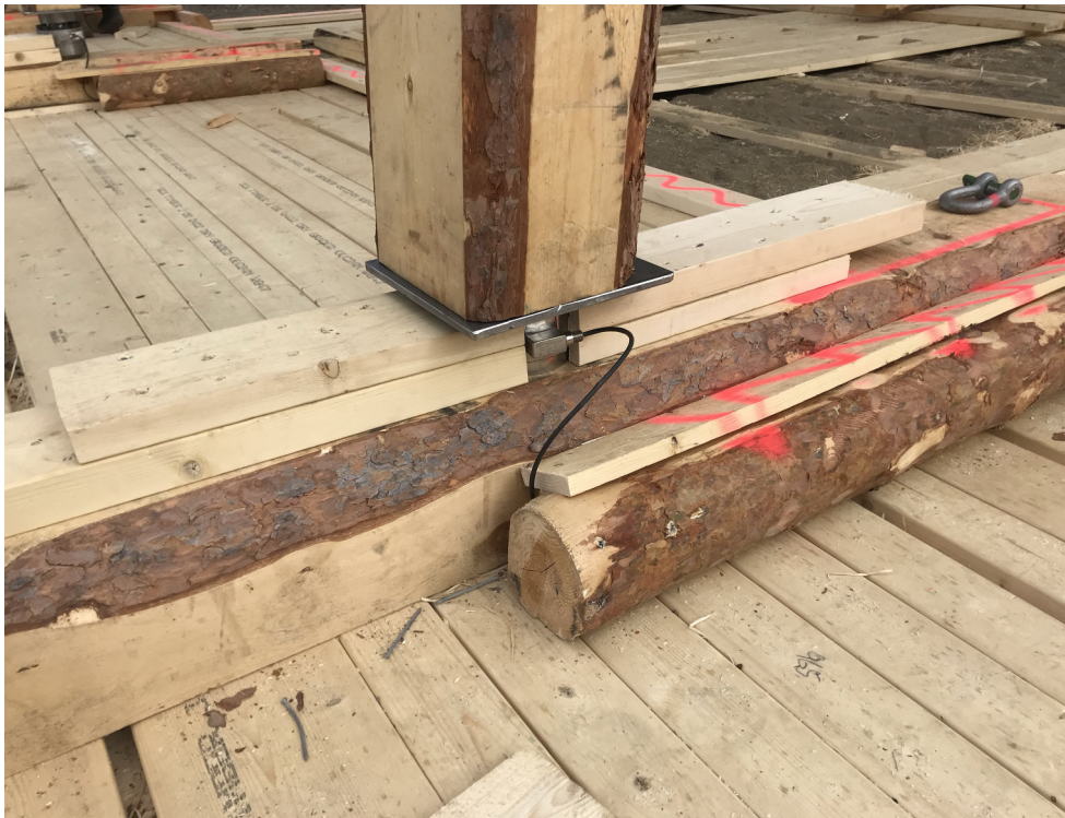
Fig. 29. Botnen av staven med stålplate, kabling og vegecelle (skjult bakom vernet).
