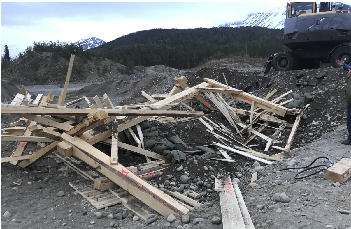
Fig 40. Konstruksjonen har nettopp kollapsa. Alle mann overlevde
