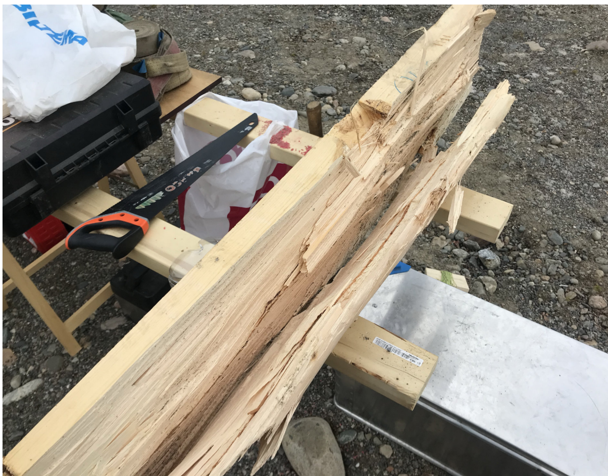
Fig. 46. Stavleia kløyvd frå sperrehakket og nedover.
